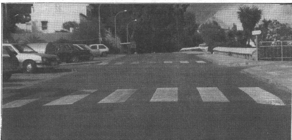
Por fin se han repintado todos los pasos cebras del Municipio, pero o la pintura no es de calidad, o no se ha hecho lo suficientemente bien. Confiamos que la Oficina Técnica del Ayuntamiento tome buena nota de esto y aplique las medidas pertinentes.
