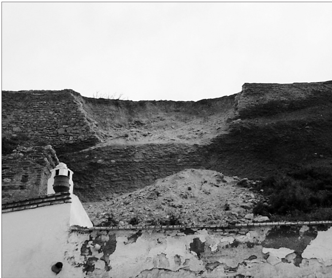
Derrumbe producido en la Alcazaba.
