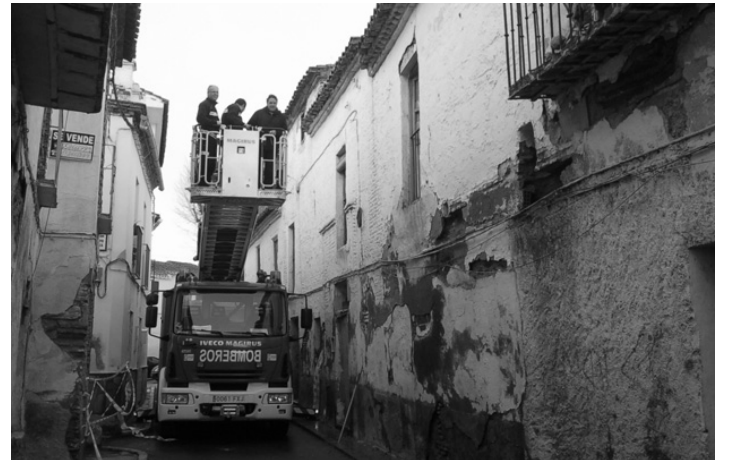
Los bomberos retiran las cornisas que amenazan con desprenderse.
