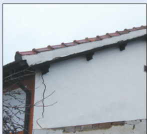
Grieta en el consultorio.
