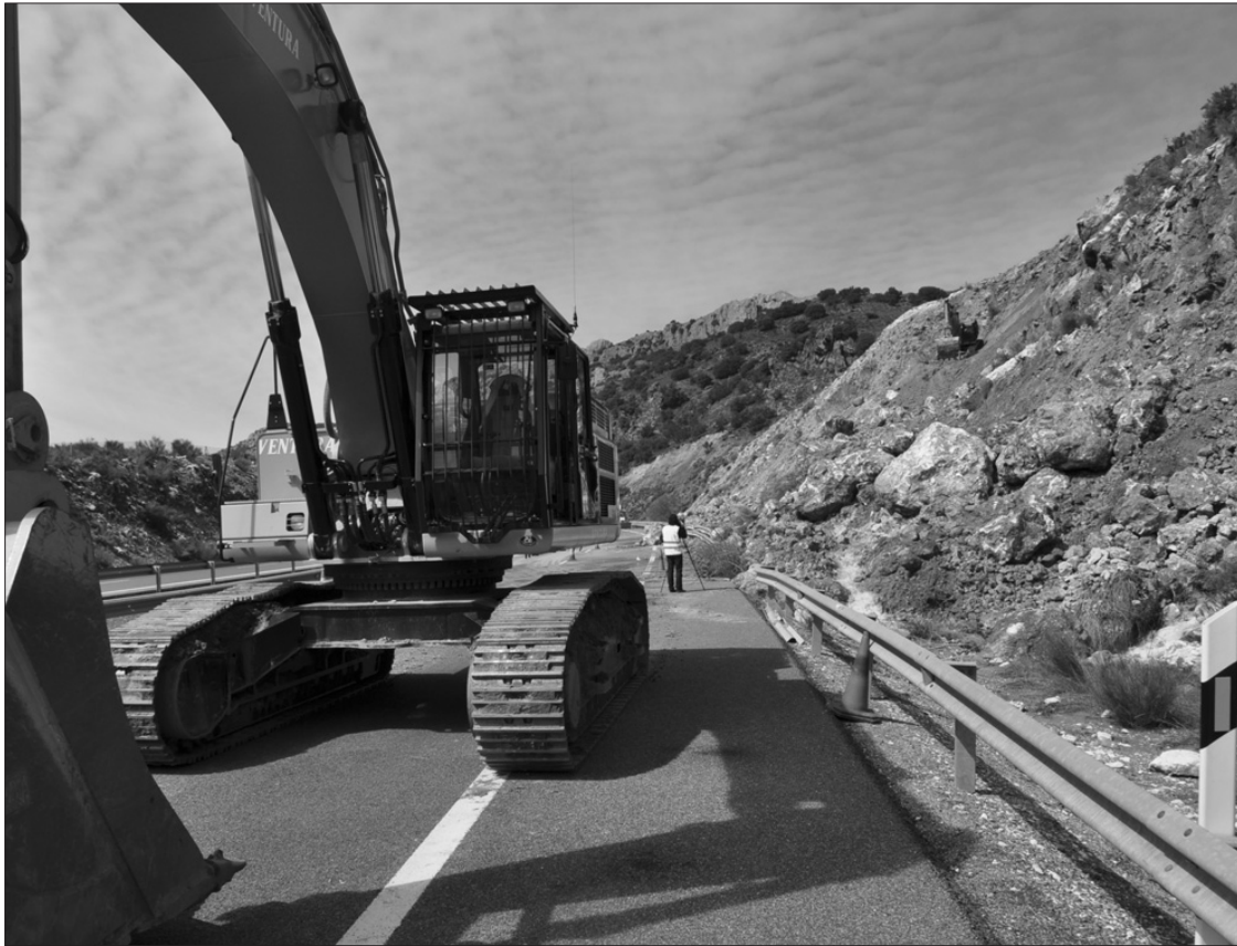
La A-92 ha sufrido más de un problema, interrumpiendo una importante vía de comunicación.
