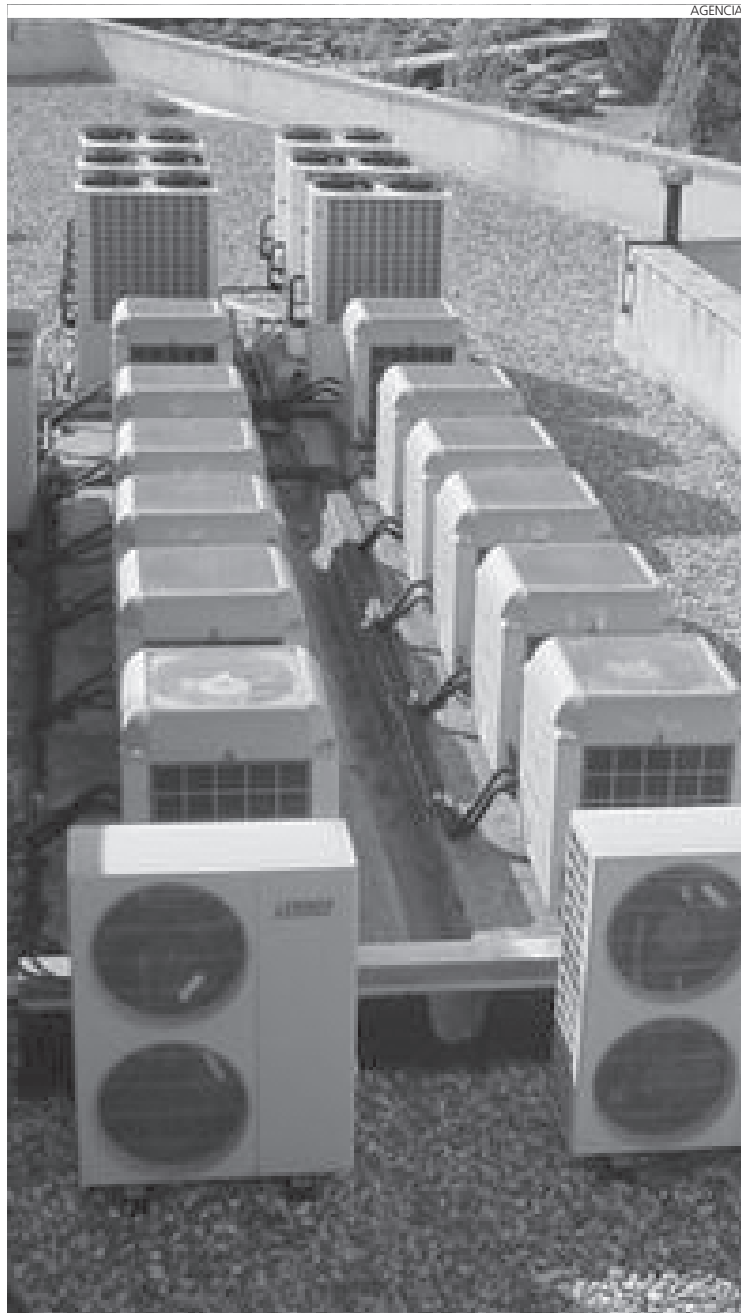
Instalaciones de climatización.
