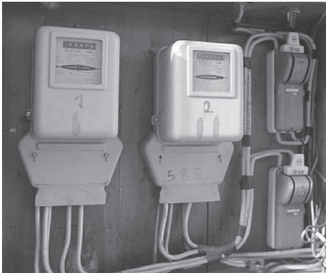
Contadores de electricidad.
