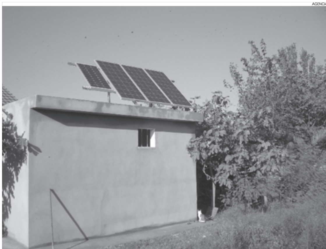
Instalación solar aislada.
