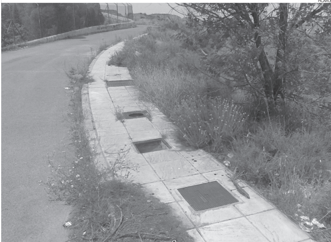
La falta de tapas de las arquetas es una de las mejoras que se necesitan.
