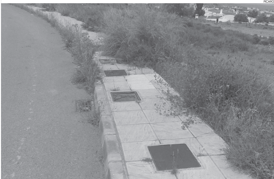
Estas arquetas están en el entorno de los cerros de Medina.
