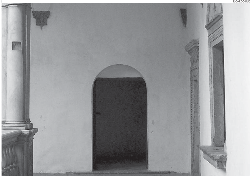
Puerta de la capilla, en la que falta la portada
