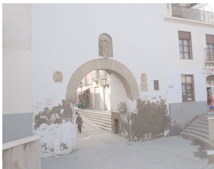
Así de mal cuidado está el arco de San Torcuato.
