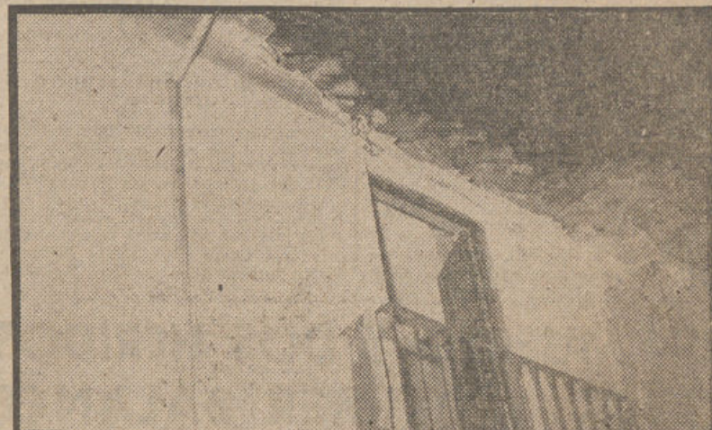
Otra casa situada en la calle de Minas de San Lázaro también sufrió los efectos de la violencia del seísmo.—(Fot. SANZ).
