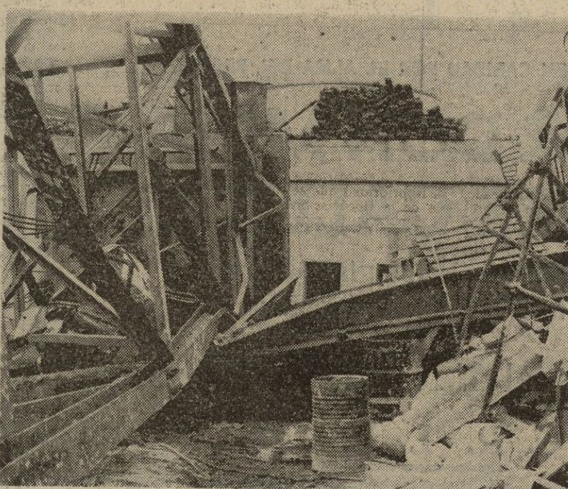
En Verina (Gijón), esta es la torre de la grúa Derrick caída sobre el alto horno número 2 cuando se procedía a su montaje en la factoría de Uninsa. En el accidente perdieron la vida cinco obreros y otros seis resultaron con heridas de diversa consideración. — (Foto EURO-PA PRESS)
