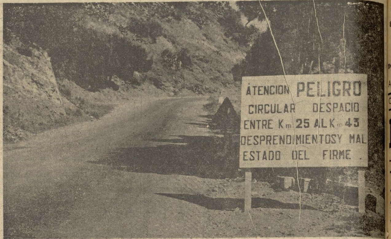
Como este letrero, existen muchos a lo largo y ancho del tramo que va desde Motril hasta el límite de la provincia de Almería. La circulación se hace peligrosa, y lo que es más probable, que cuando lleguen las lluvias, ni siquiera se pueda mantener el paso de vehículos, como hasta ahora. — (Foto FERRER)
