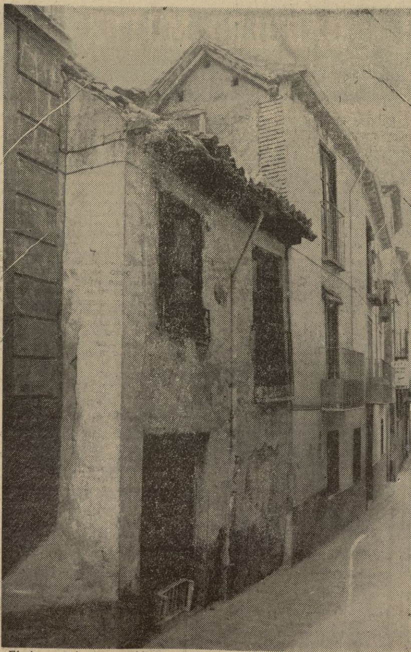
El Ayuntamiento acordó en su última reunión proceder a la demolición de esta casa, en calle Rosario, 20, pues se encuentra en avanzado estado de ruina y el día menos pensado dará con sus vetustos muros en tierra. El inmueble pone en peligro permanente a los transeúntes de la calle del Rosario.—(Foto FERRER)
