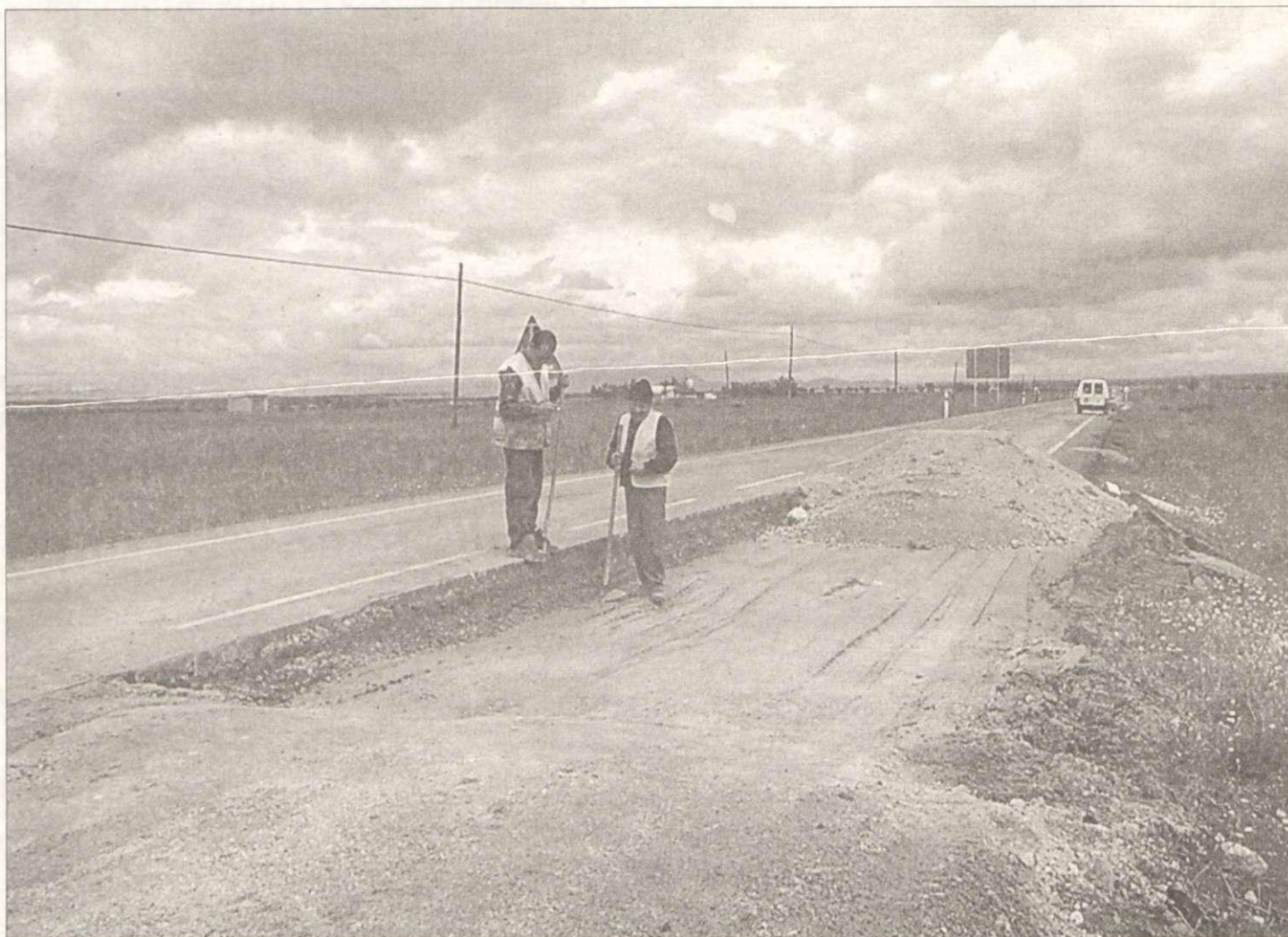
Los socavones son constantes en la carretera que une Jérez con Guadix.
