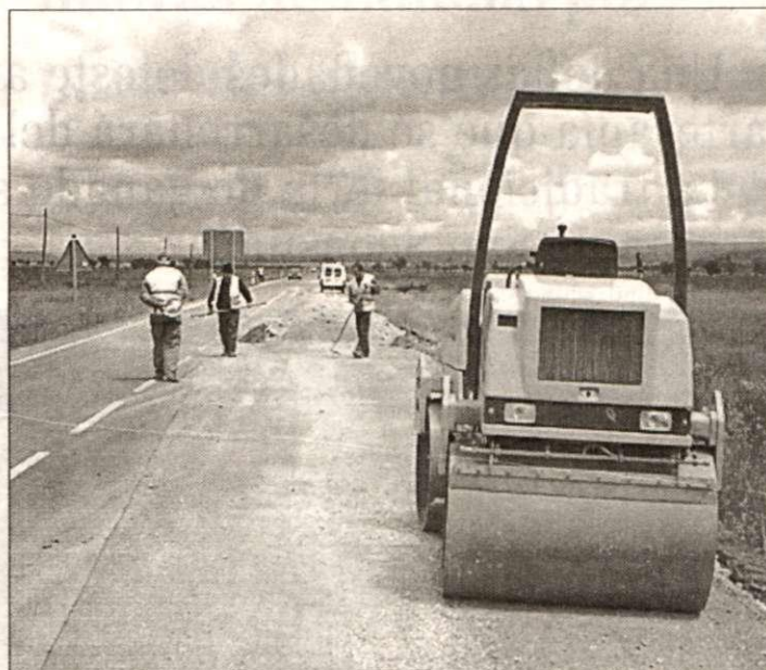
Serías deficiencias en esta vía.
