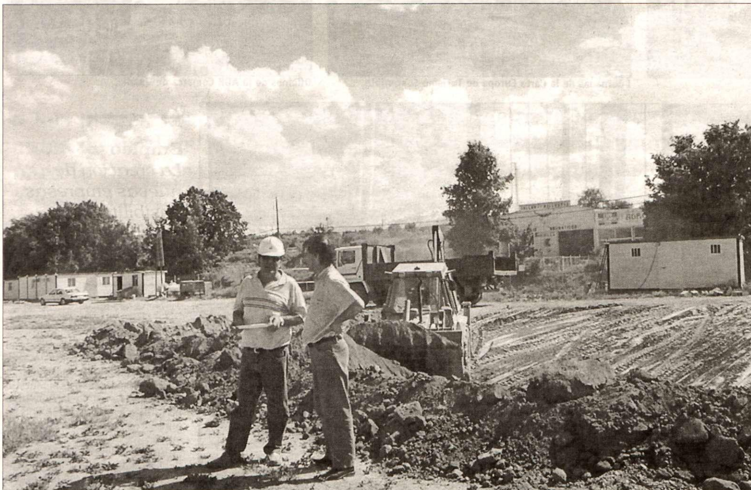
El concejal de Salud inspecciona junto al responsable de Cartuja Inmobiliaria el estado de las obras.
