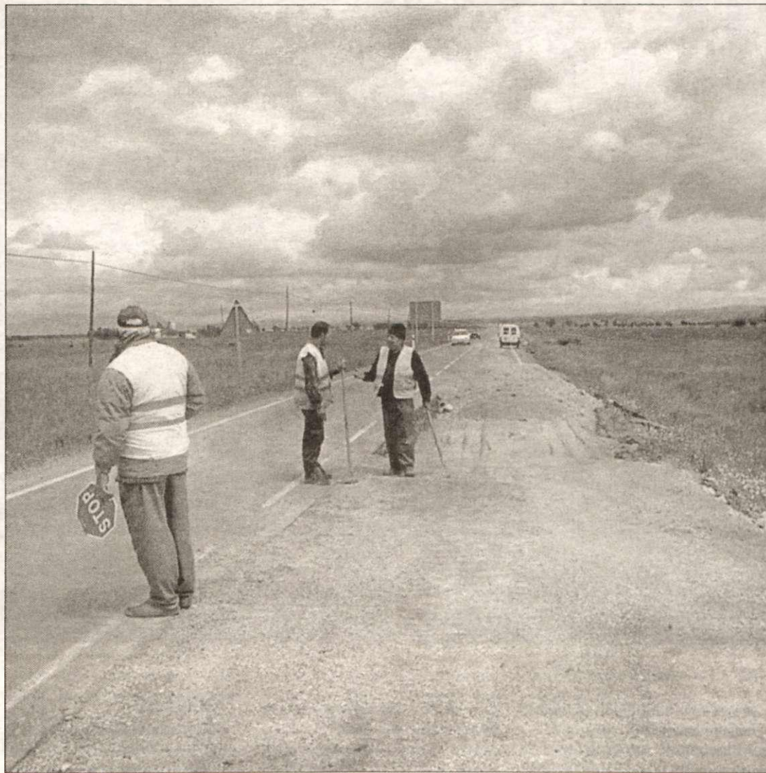
Pésimo estado de la carretera de Jérez del Marquesado.
