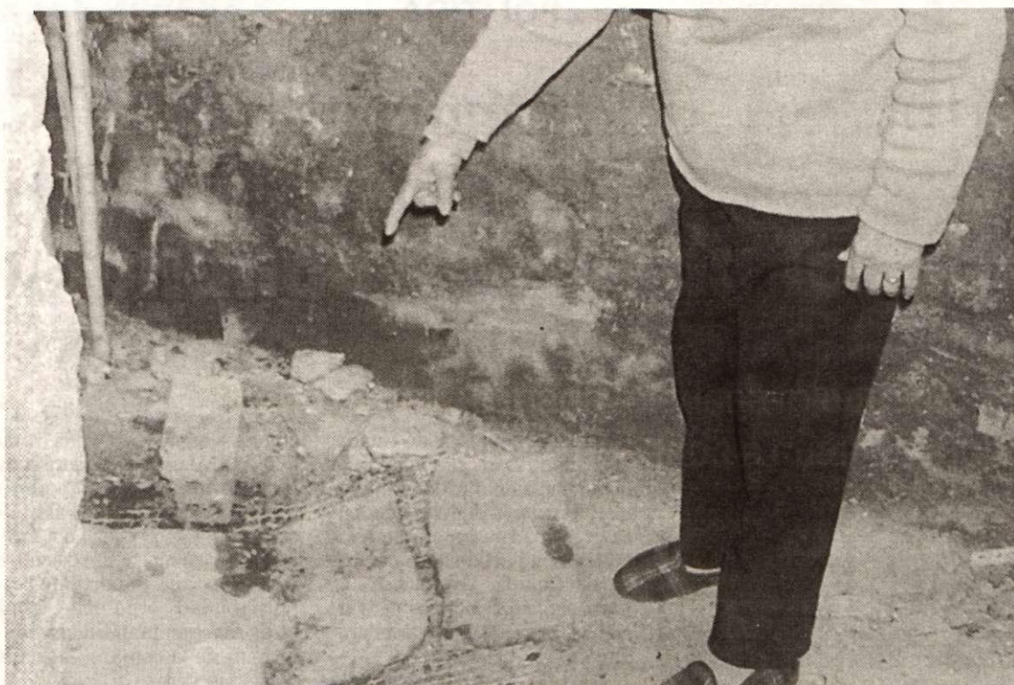
Una de las viviendas afectadas.
