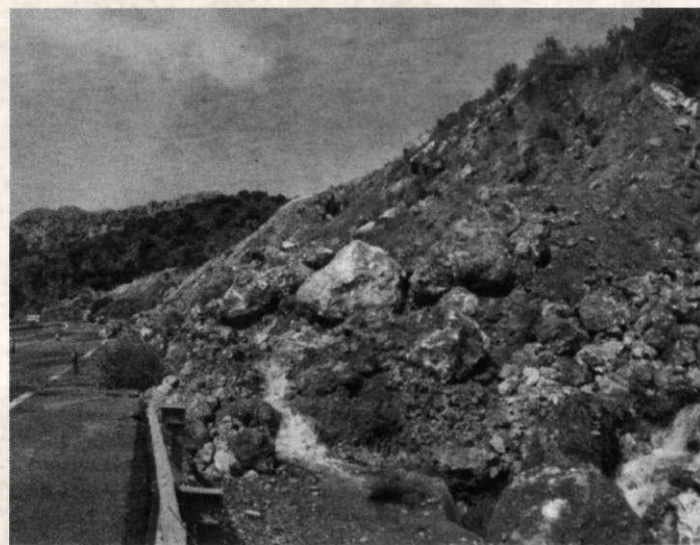
Una de las zonas de la autovía dañadas por el temporal.
