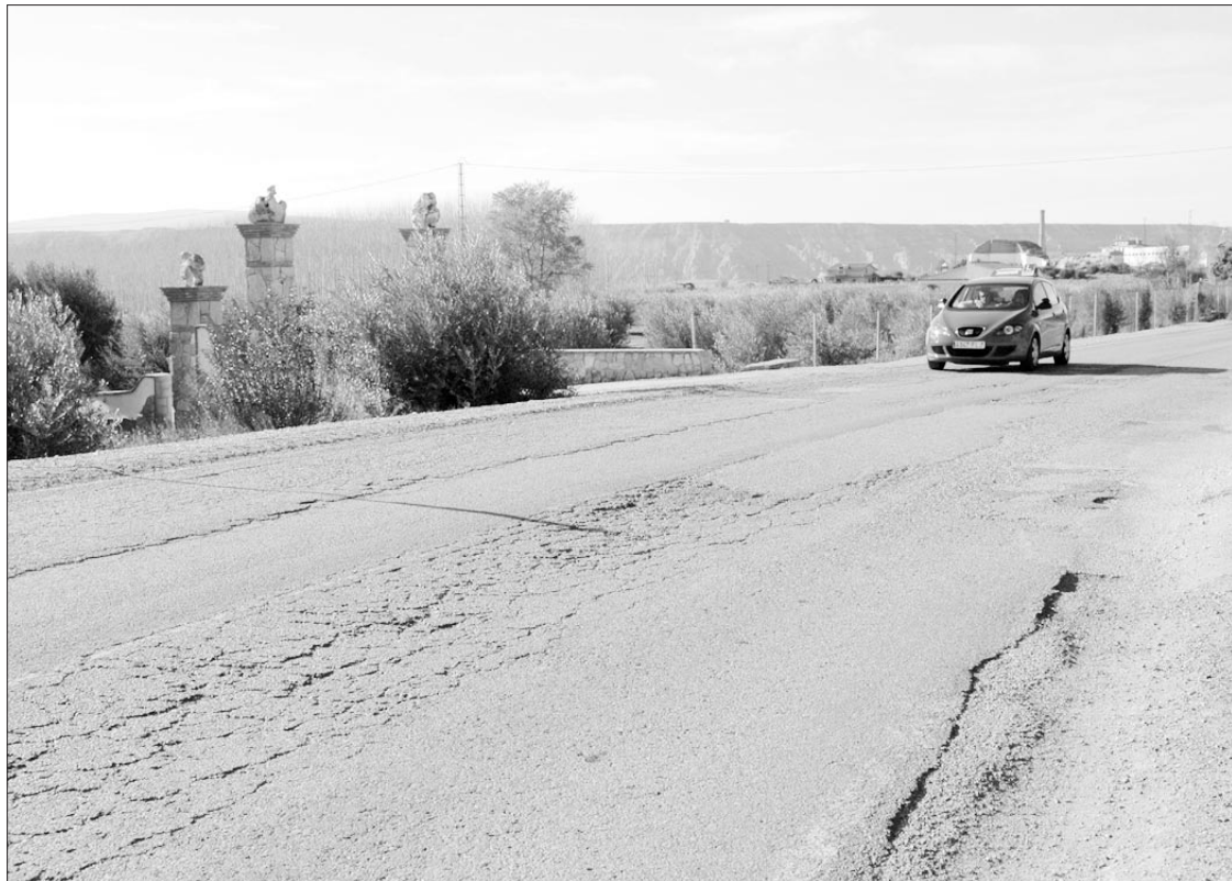
Carretera de Benalúa.
