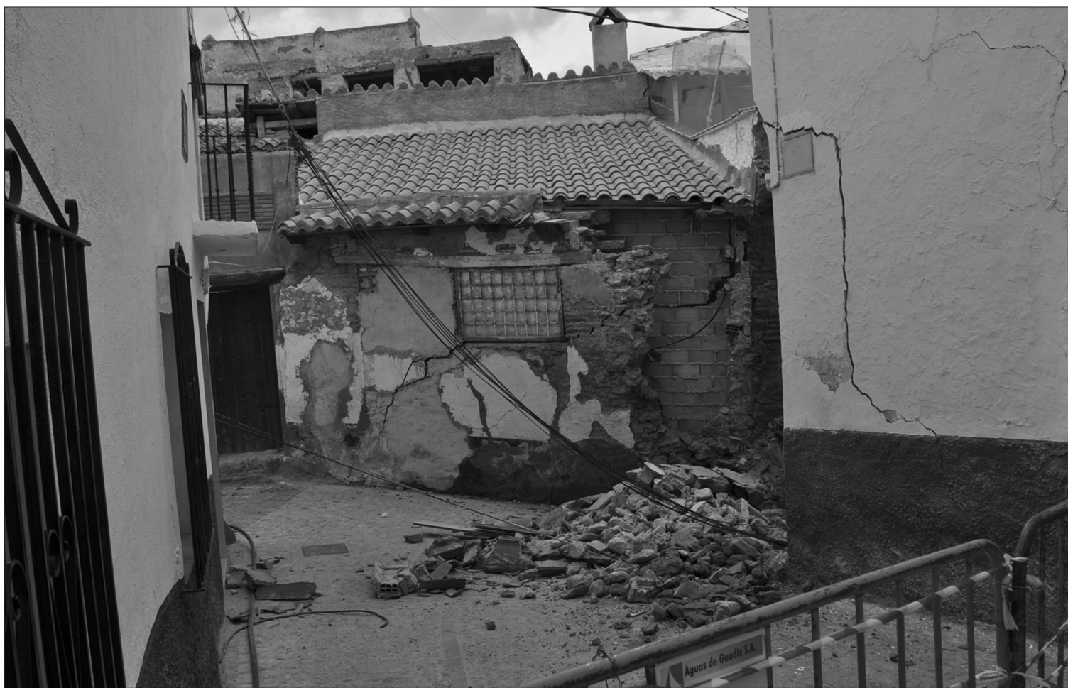
Una de las viviendas afectadas.
