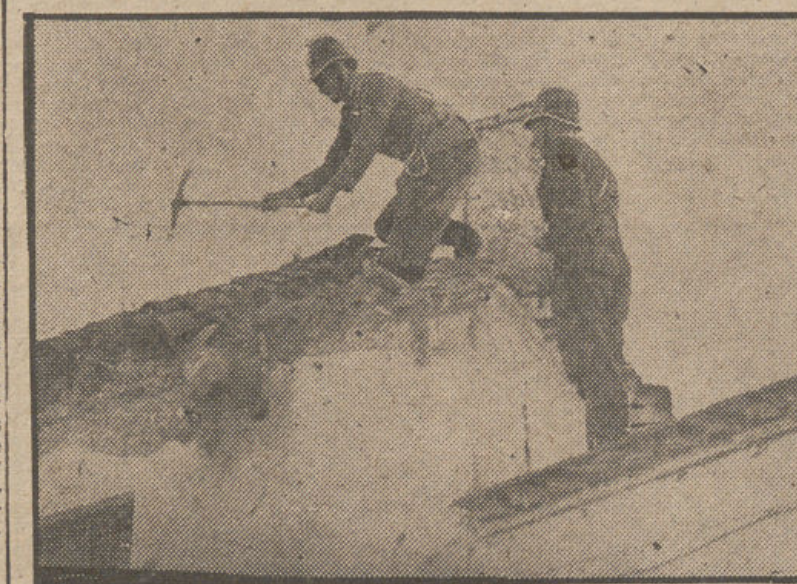
Bomberos del Parque de Granada derribando el tejado de una de las casas afectadas por el terremoto.—(Fot. SANZ).
