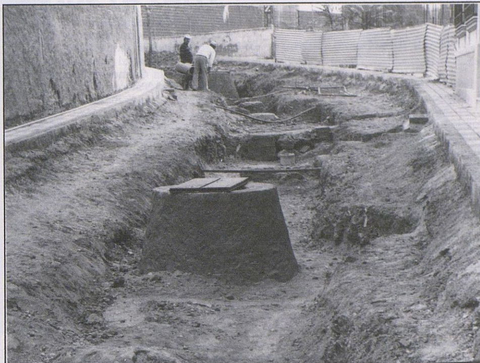
Nuevos acerados y reparación de la calzada en "Baños de San Juan" y "Santo Cristo", incluida la reposición de tuberías.
