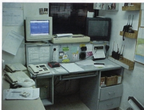
Centro de recepción de datos.
