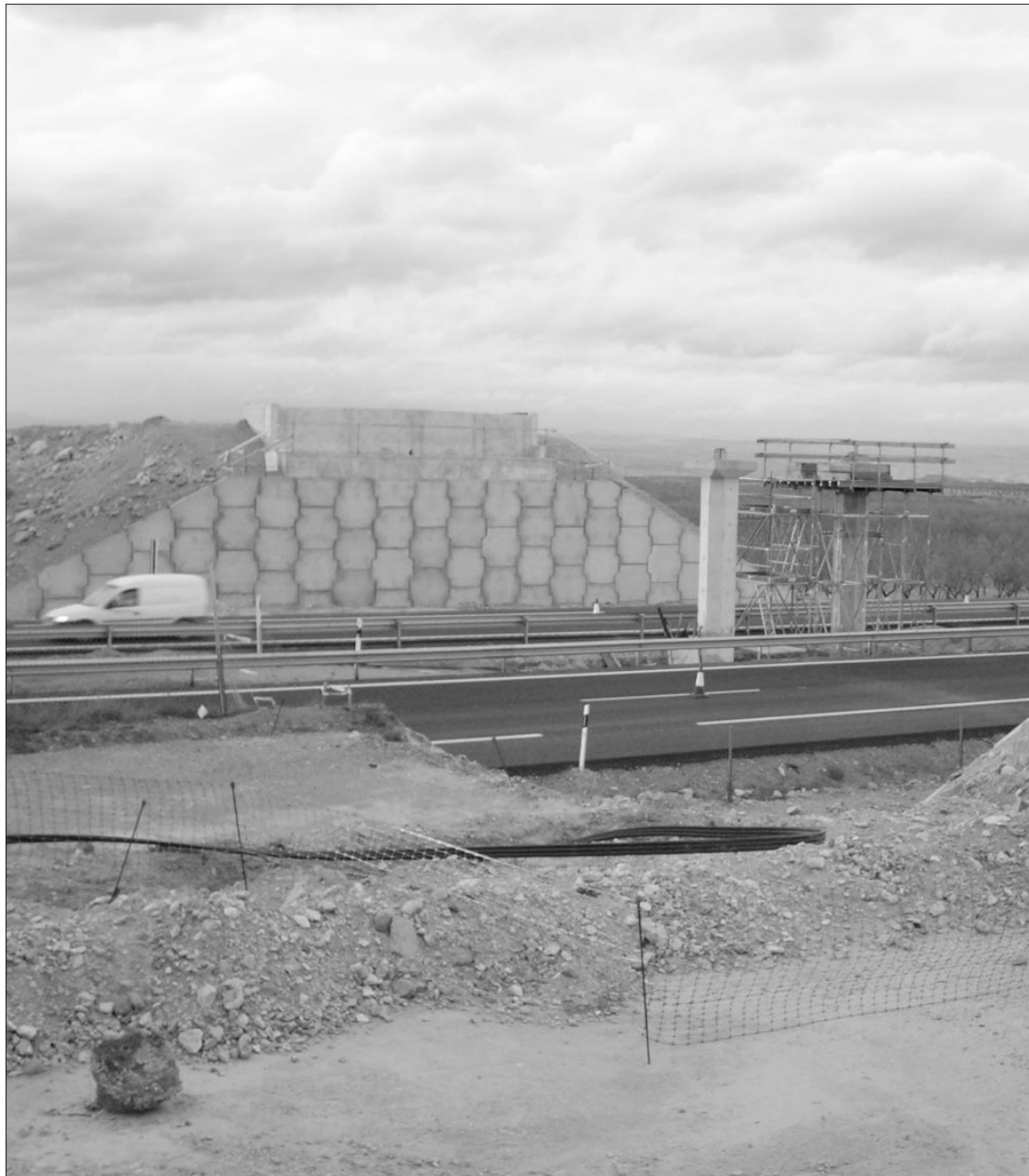
Puente de enlace con la autovía, que está previsto finalizará en breve.
