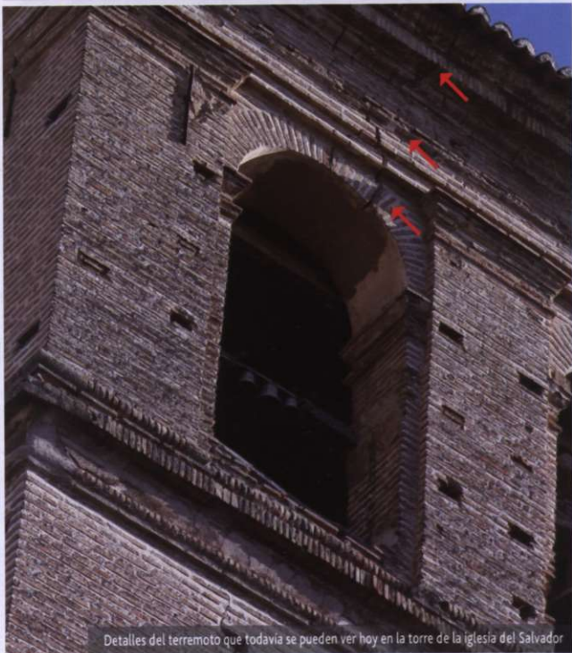
Detalles del terremoto que todavía se pueden ver hoy en la torre de la iglesia del Salvador
